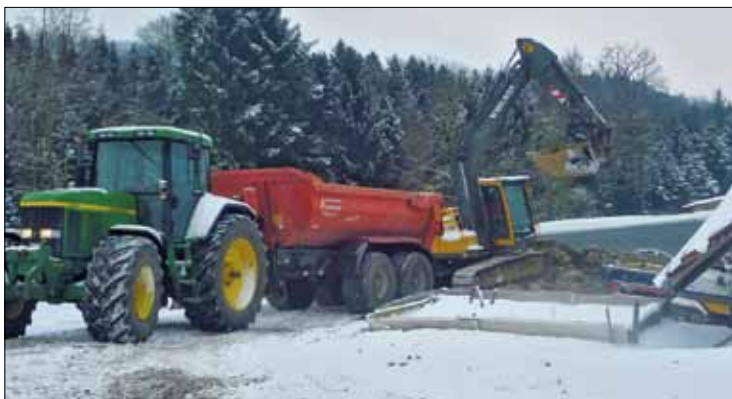
Baustelle auf dem Hof der Familie Knüsel: Der Stall wird für die Muttertierhaltung umgebaut.
